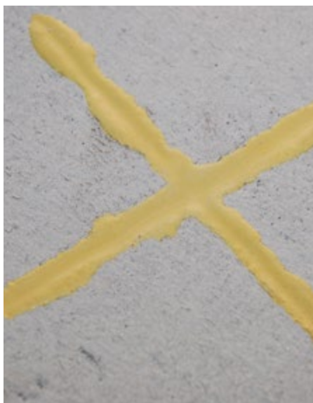
✗ Nedostatečné provedení sanace trhlin
